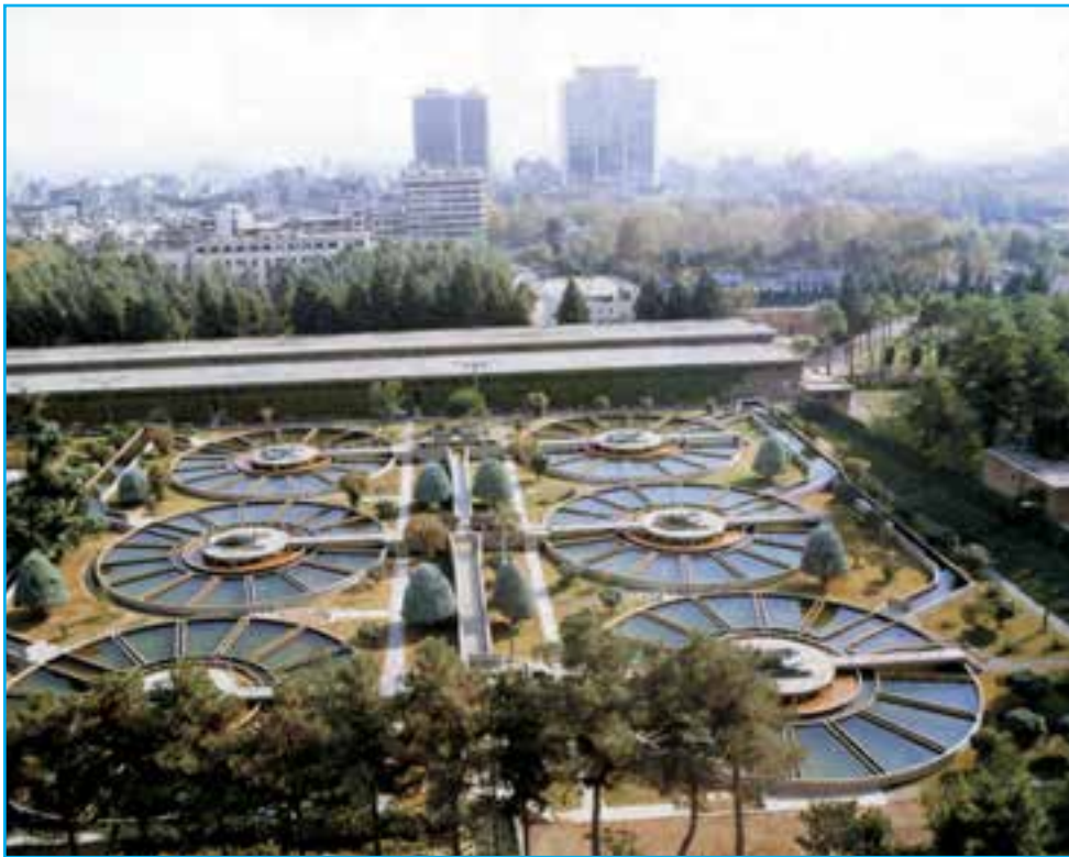
شکل ۱۴-۹- تصفیه خانه شماره ۲ آب تهران - جلالیه
