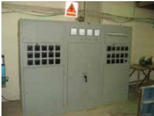
شکل ۱۴۹-۱۵- تابلوی اصلی برق ماشین‌آلات کارگاه صنایع چوب.
