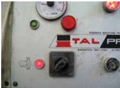
شکل ۲۳-۱۵- کلید روشن کردن پمپ (الکتروپمپ های ۱ و ۲).
