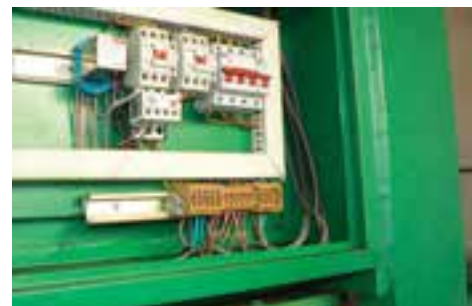
شکل ۱۵-۳۸- فیوزهای فودکار مینیاتوری روی تابلو برق پرس.
