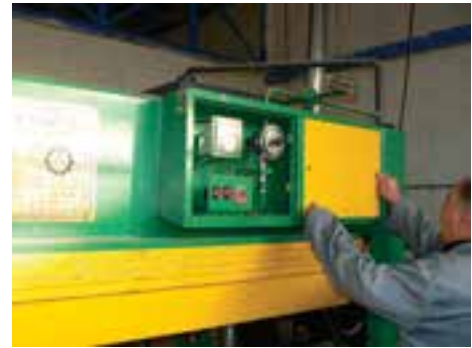
شکل ۱۵-۳۷- تابلوی نصب شده روی دستگاه پرس.
