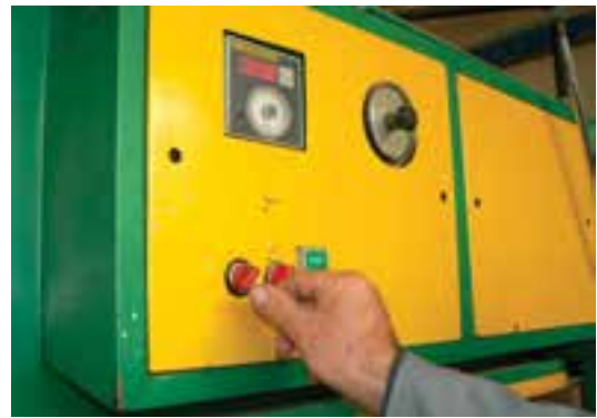
شکل ۱۵۱-۱۵- تابلوی برق اختصاصی (روی پرس روغنی).
