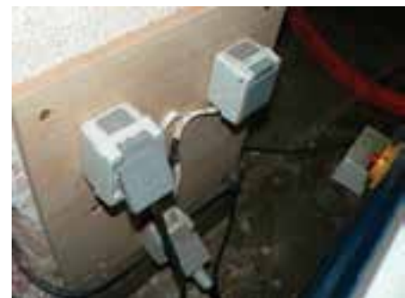
شکل ۲۱۳-۱۶- تابلو برق غیر استاندارد.
