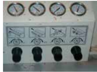
شکل ۲۰۴-۱۶- گیج‌های کنترل فشار هوا.
