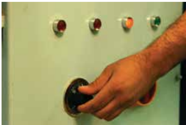
شکل ۱۳۳-۱۶- تنظیم حرارت با گیج مدرج مفصوم.
