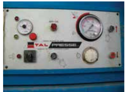
شکل ۱۶۲-۱۵- تابلو کنترل و کلید روشن کردن پرس.
