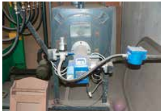
شکل ۱۳۰-۱۵. تجهیزات مشعل حرارتی (روی دیگ روغن پرس).
