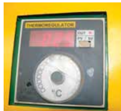
شکل ۱۳۳-۱۵. گیج تنظیم حرارت.
