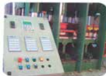
شکل ۱۱۶-۱۵- تابلو کنترل برقی سیستم پرس (روکش ملامینه).
