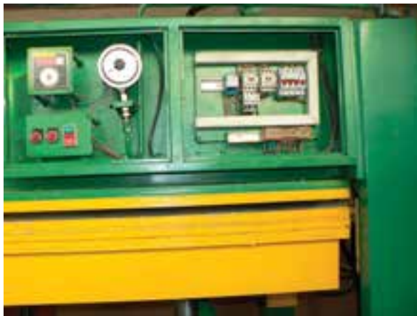
شکل ۴۴-۱۵. گیج‌های حرارتی و فشار در ارتباط با فیوزهای اتومات.
