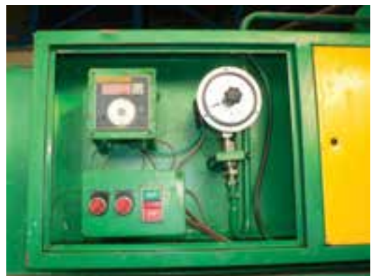
شکل ۱۵۲-۱۵- کنترل تابلوی برقی گيج‌های حرارت - فشار پرس (روغنی).
