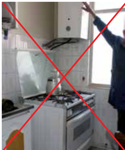
شکل ۱-۶ نصب نادرست آب گرم کن.
