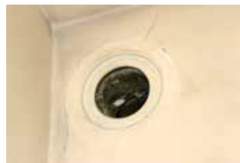
شکل ۱-۴ دودکش در محل نصب آب گرم کن.
