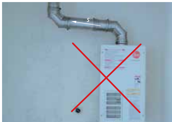
شکل ۱-۳۶ اتصال نادرست دودکش
