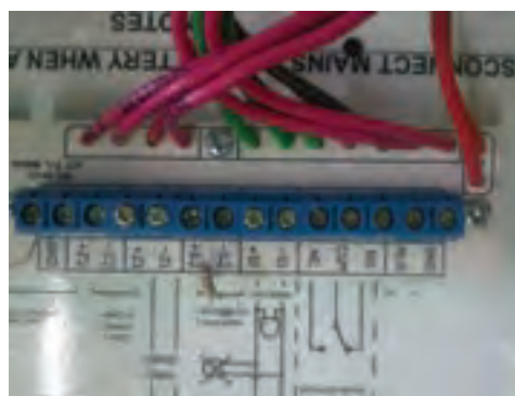
شکل ۱-۳۱ ترمینال های اتصال
