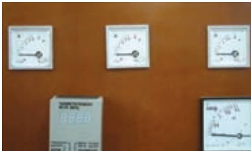
شکل ۱۱-۶- آمپرمترهای اندازه‌گیری جریان فازها
