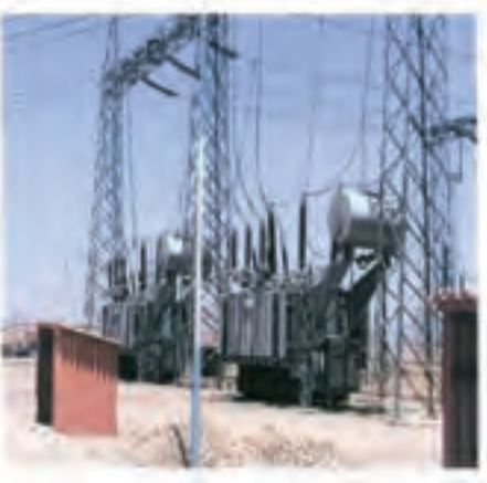
شکل (۲۸-۳) دو ترانسفورماتور موازی شده
