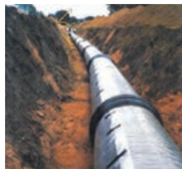
▲ شکل ۲-۲۱ لوله کشی انتقال آب شهری
