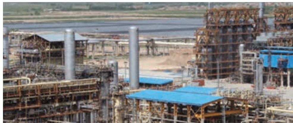
شکل ۴- نمایی از یک برج تقطیر برای جداسازی اجزای هوا در پتروشیمی اهواز
