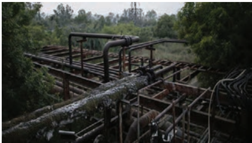
شکل ۲۲- خطوط لوله آسیب دیده در کارخانه یونیون کارباید
