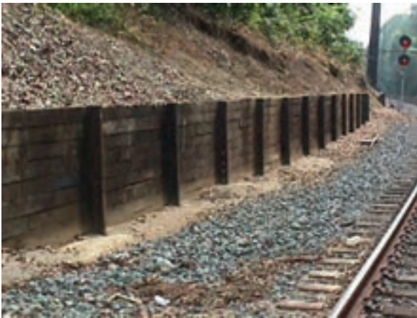
الف) دیوار دائمی برای حفاظت در مقابل ریزش سنگ و برف
