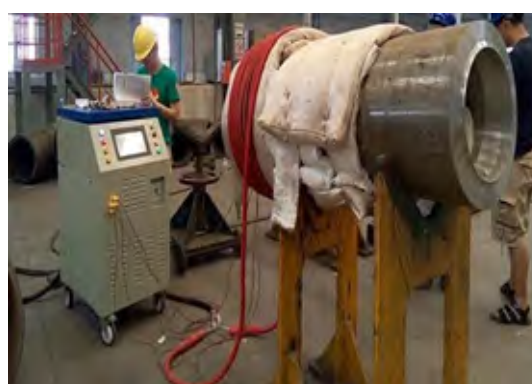
تجهیزات الکتریکی که جهت کنترل حرارت پس گرم استفاده می‌شود.
