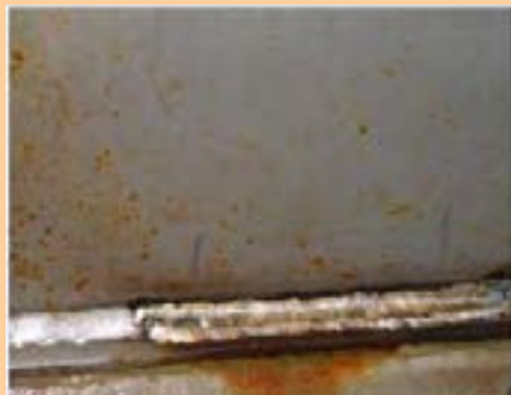
شکل ۴-۶- چگونگی سطوح خورده شده
