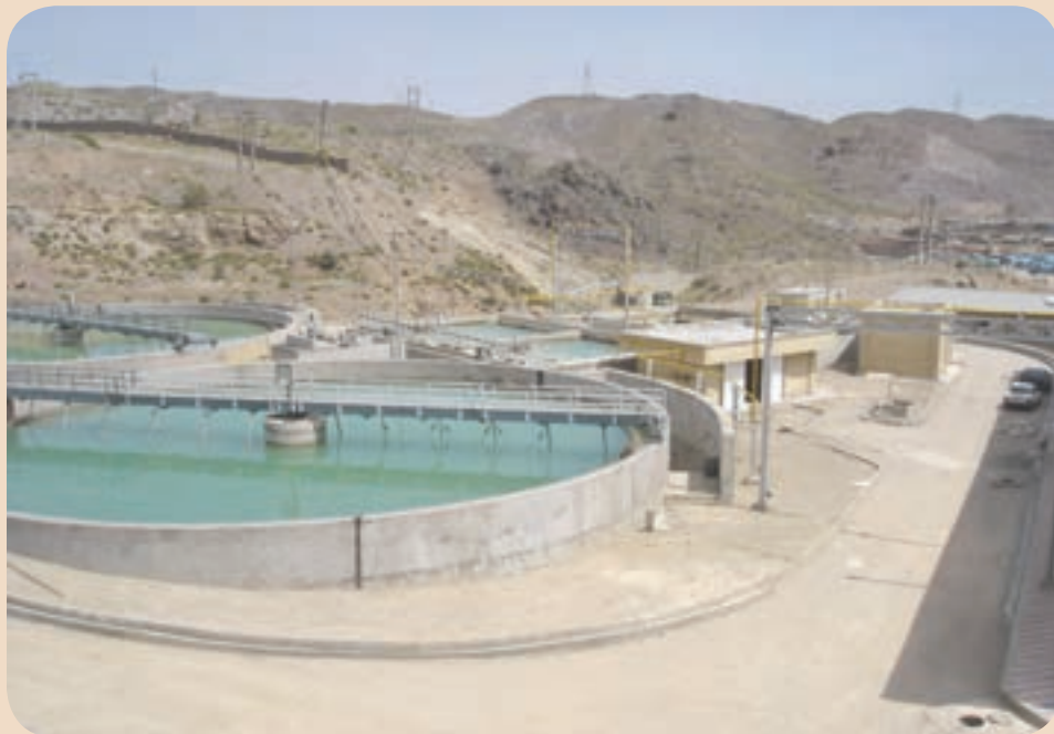
شکل ۱-۶۰- تصفیه خانه مجتمع مس سرچشمه
