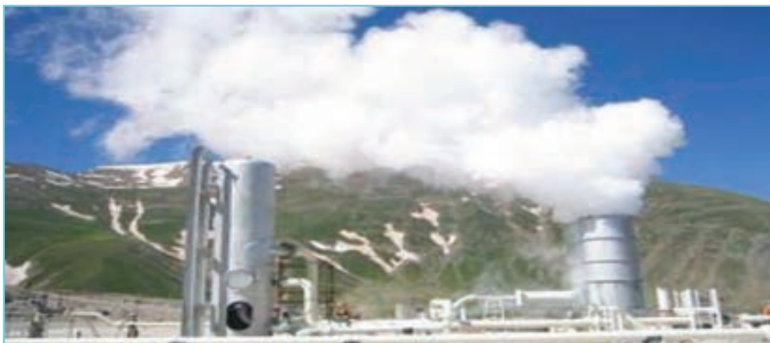
شکل ۲۴-۵- تأسیسات زمین گرمایی مشکین‌شهر
