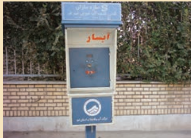
شکل ۷-۶- تصویر یکی از ایستگاه‌های توزیع آب شیرین (آبسار) در شهر قم
