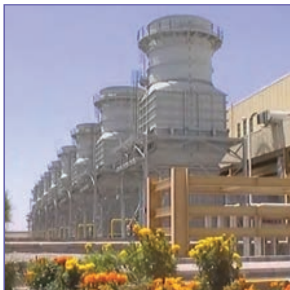
شکل ۶-۶- نیروگاه سیکل ترکیبی کرمان
