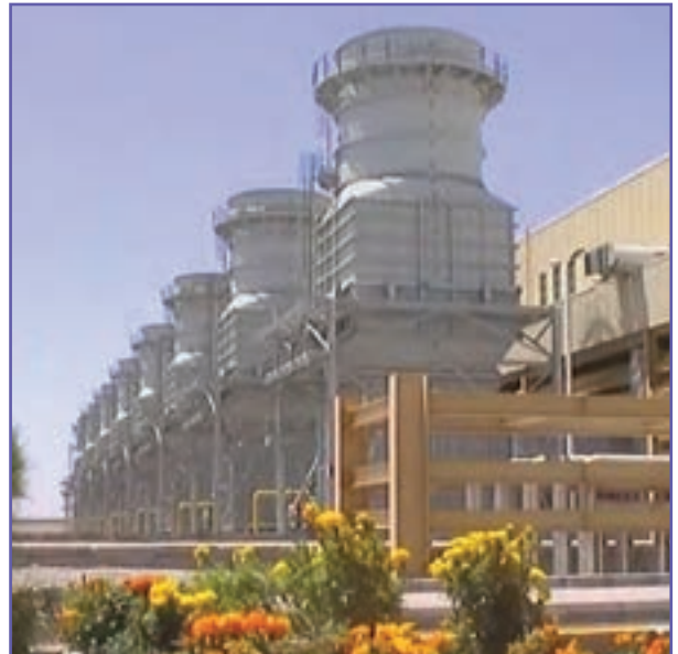
شکل ۶-۶- نیروگاه سیکل ترکیبی کرمان
