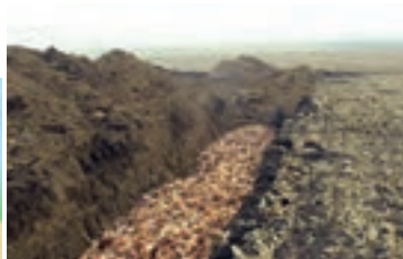
دفن کردن در چاله‌های عمیق
