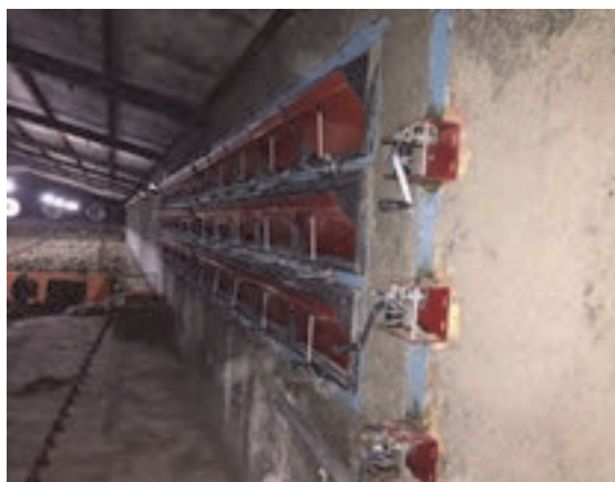
ورود هوا از طریق پنجره‌های خودکار (اینلت)
