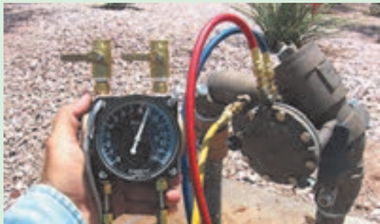
شکل ۳۱-۵. تنظیم فشار شیر فشار شکن
