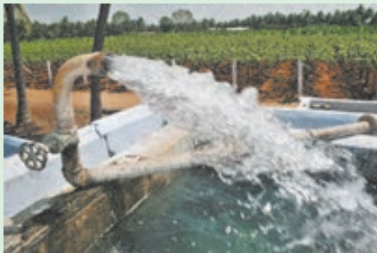
شکل ۳۰-۵. لوله برگشت آب
