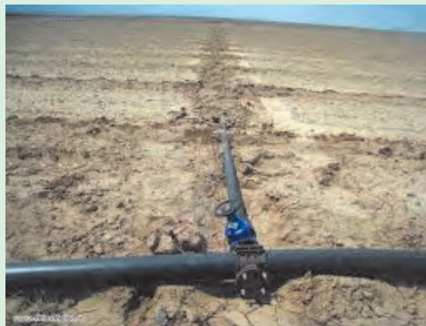
شکل ۴۶-۵. شیر فلکه لوله جانبی
