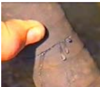
شکل ۶. نشتی از شیلنگ‌ها
