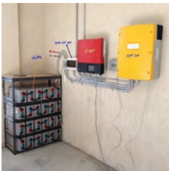
شکل ۴۲- اتصالات سامانه فتوولتائیک
