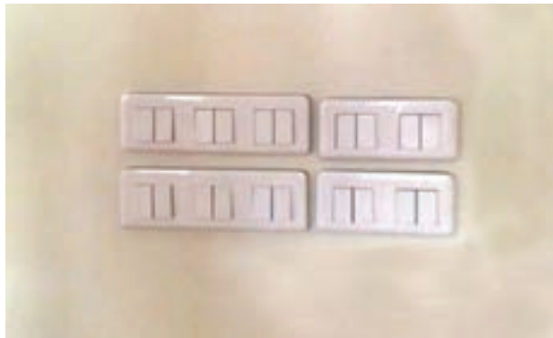
شکل ۱۴- چیدمان نامناسب کلیدها
