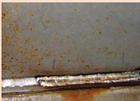
شکل ۶-۴ - چگونگی سطوح خورده شده
