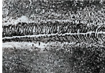
شکل یک ترک سطحی
