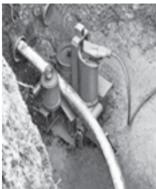
شکل ۵-۵۱- دستگاه کشش کابل
