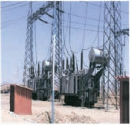
شکل (۲۸-۳) دو ترانسفورماتور موازی شده
