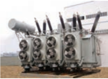
شکل (۳-۱) ترانسفورماتور خطوط انتقال
