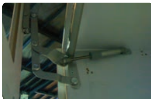
شکل ۶-۳۸ در کابینت نصب شده با جک اتوبوسی
