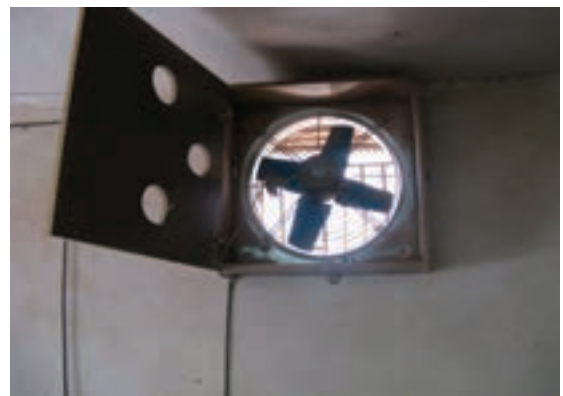
شکل ۴۷-۱۳- یک دستگاه تهویه در اتاق رنگ‌کاری.
