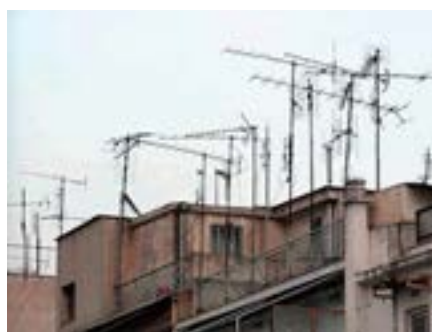
شکل ۳- تعداد زیادی آنتن نصب شده روی بام چشم‌انداز ناخوشایندی ایجاد می‌کند.
