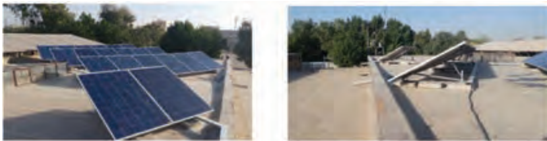
شکل ۲۴- نیروگاه برق خورشیدی نصب شده به ظرفیت ۳kw در هنرستان فنی و حرفه ای شهید بهشتی دزفول
