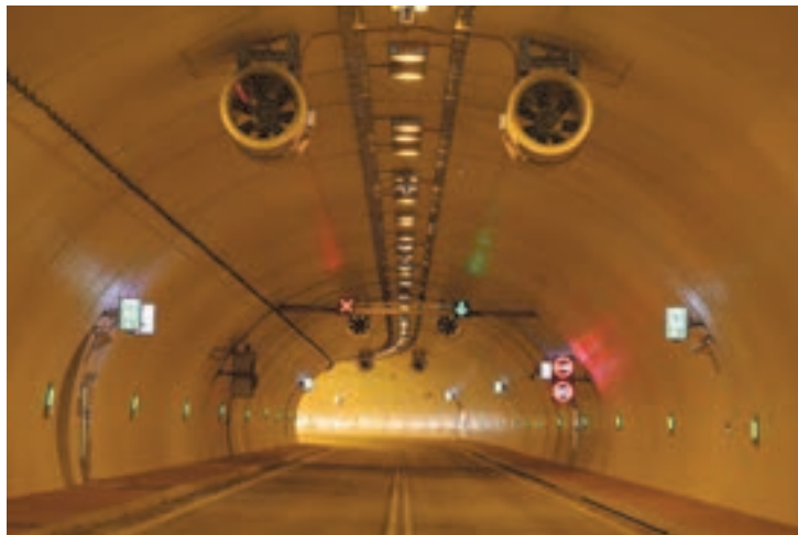
شکل ۱۸- تهویه‌های هوای نصب شده در تونل
