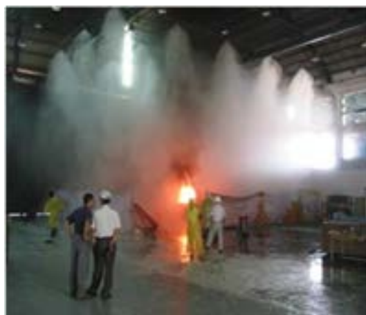
شکل ۱۱-۴: سیستم پاشش آب اطفاء حریق
