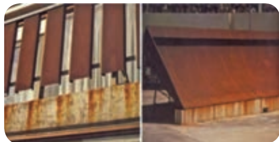
سطح زنگ‌زده ورق‌های آهنی در اثر قرارگرفتن در شرایط اتمسفر مرطوب
