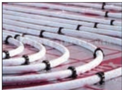
لوله کشی با لوله های ترموپلاستیک
