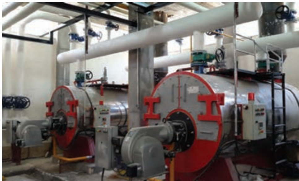
شکل ۲- نمایی از یک موتورخانه
