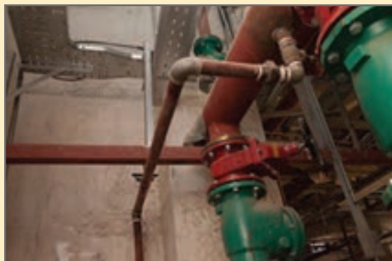
خط تخلیه کلکتور به همراه شیر فلکه کف فلزی
