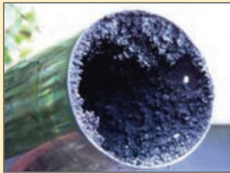
دوده ایجاد شده در داخل لوله
