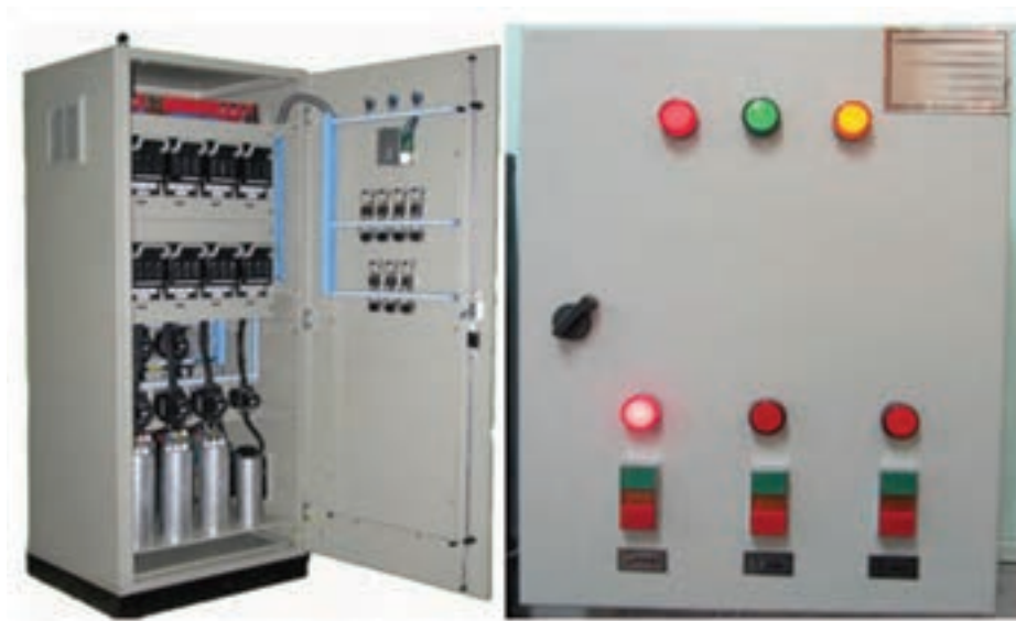
شکل ۴- تابلو برق ایستاده
