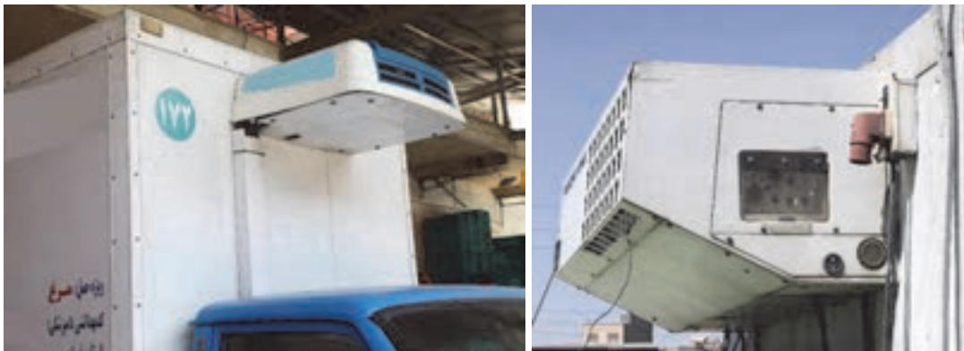
شکل ۲۱- تجهیزات سرمایشی نصب شده بر روی وسیله‌نقلیه
