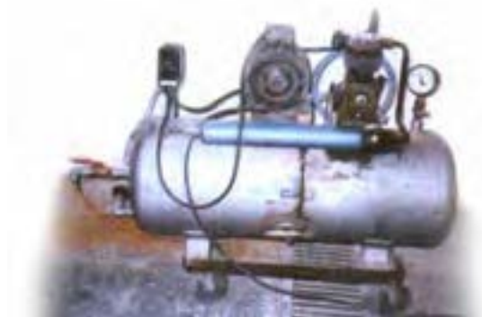
شکل ۱۷-۸. در صورت باز بودن شیر، کمپرسور همواره در حال کار کردن خواهد بود.
