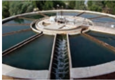
آب در تصفیه‌خانه
