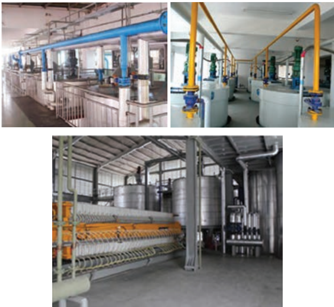
شکل ۱۰- سیستم تجهیزیات جزء به جزء کردن روغن
