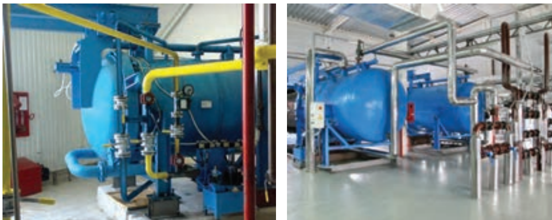
شکل ۱۲- سیستم زمستانه کردن روغن ها
