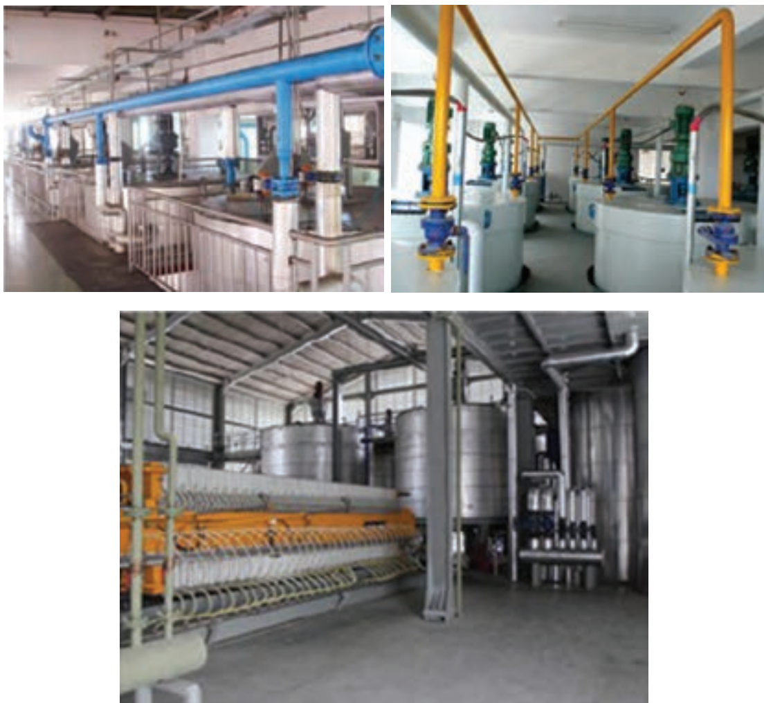
شکل ۱۰- سیستم تجهیزات جزء به جزء کردن روغن
