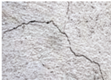
ترک خوردگی انقباضی بتن
