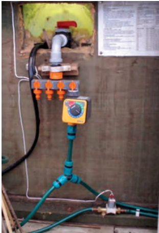
بخشی از سیستم آبیاری اتوماتیک
