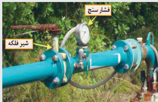
شکل ۱۹- محل شیر فلکه و فشار سنج روی لوله رانش
