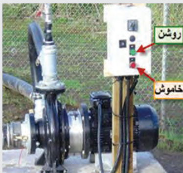
شکل ۲۰- کلیدهای کنترل روی تابلو
