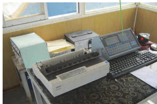
اتاقک کنترل باسکول
