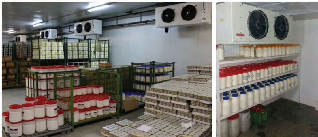
شکل ۲-۱۰- سردخانه نگهداری ماست
