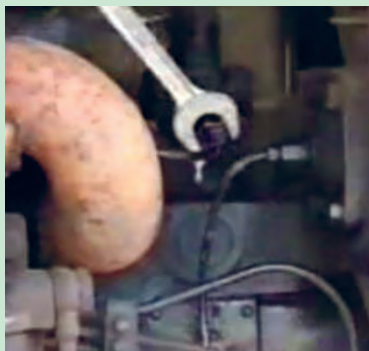
شکل ۲۹. شل کردن مهره لوله پر فشار انژکتور
