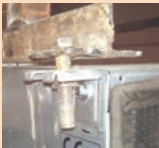
اشکال در نصب
